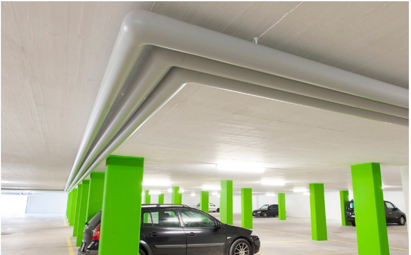
Qualität auf der ganzen Linie: Warm- und Kaltwasserleitungen in der grosszügig konzipierten Garage.
