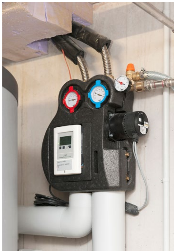
Die Solarstation überwacht die Temperatur der thermischen Solaranlage.
