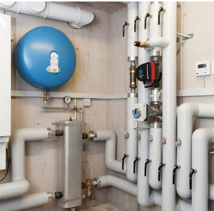
Kompakte Haustechnik: Der Technikraum vom Haus A.
